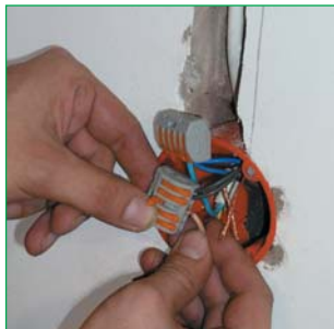
▲ Электрические соединения в сервисной коробке
